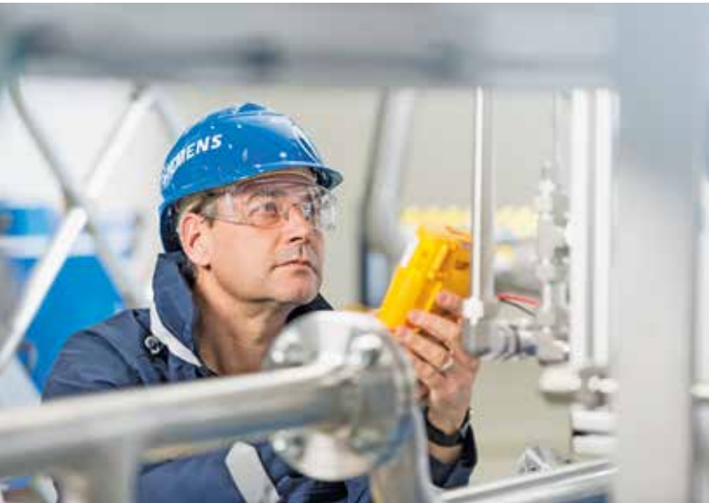
Abb. 1: Siemens-Ingenieur bei der Prüfung der gase- und wasserführenden Druckkomponenten beim Silyzer
