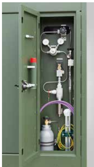
Abb. 4: Armaturenschrank mit weiteren Versorgungskomponenten [Foto: WTD 41]
