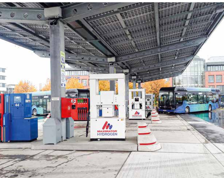
Abb. 1: H 2 -Tankstelle Clean Energy Station: Gut zu erkennen ist die Photovoltaikanlage, mit der das Dach der Tankstelle vollflächig belegt ist. [Quelle: Emcel]
