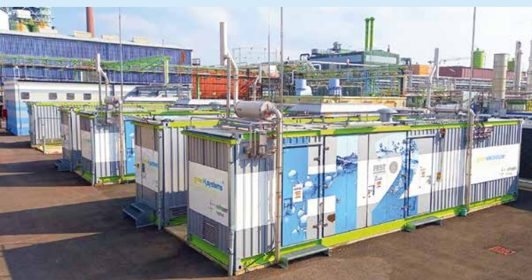
Abb. 1: Die neue Anlage im Industriepark Höchst, einem der größten Chemie- und Pharmastandorte in Europa, produziert grünen Wasserstoff. [Quelle: FEST GmbH]
