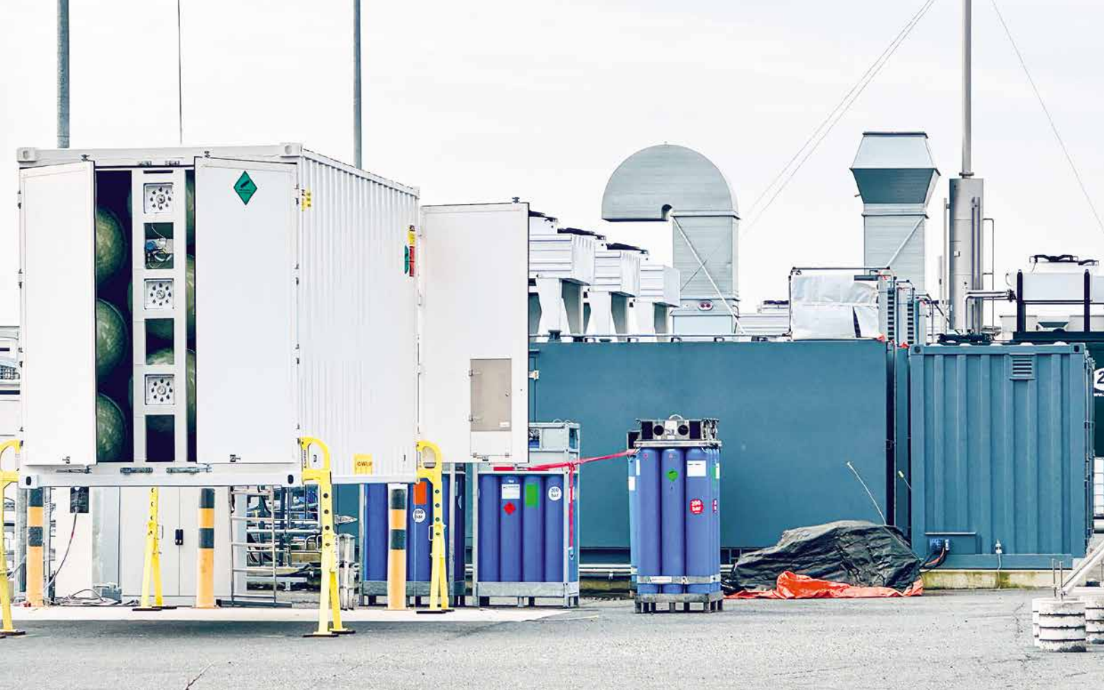
Abb. 2: Container mit verschiedenen Wasserstoffspeichern (links) und Blockheizkraftwerk [Quelle: Monika Rößiger]
